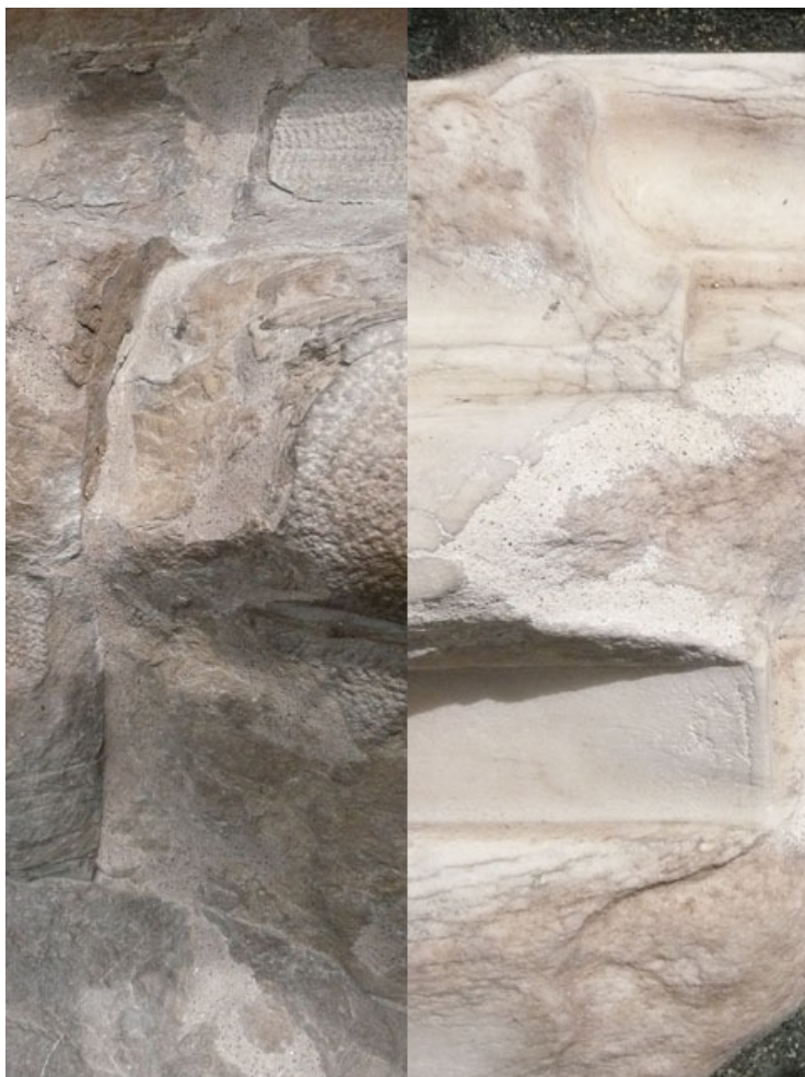
Rys. 14: wypełnienia na krawędziach ubytków kamieni piaskowca (po lewej) marmuru (po prawej).
