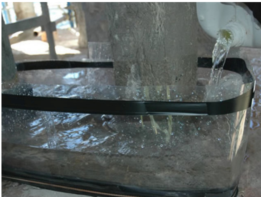
Rys. 10: nasączenie krzemianem etylowym mocno uszkodzonej podstawy kolumny z piaskowca.
