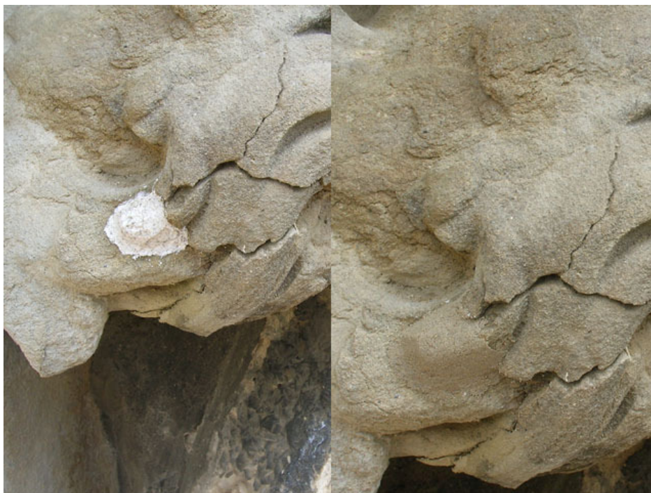
Rys. 14:rekonstrukcja sztukateryjna (po lewej) I wykończenie (po prawej) na detalu dekoracyjnym z piaskowca.
