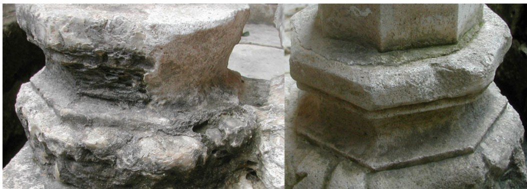
Rys. 4: porównanie kolumny pokrytej konkrecją węglanową (na lewo) z kolumną bez niej (na prawo).
